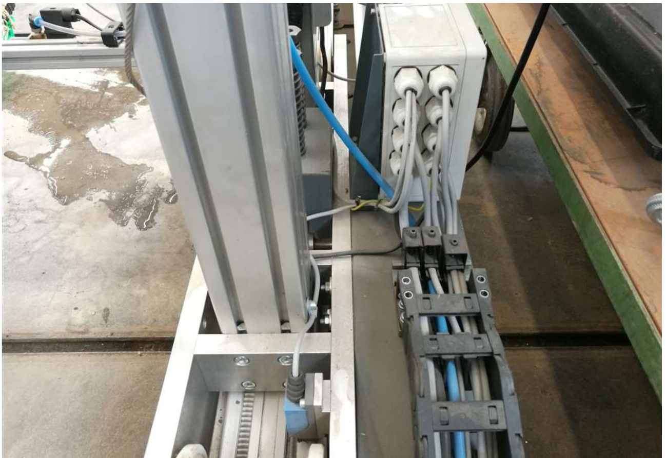
Abbildung 10 Die in der Energiekette gekapselten Stromkabel
